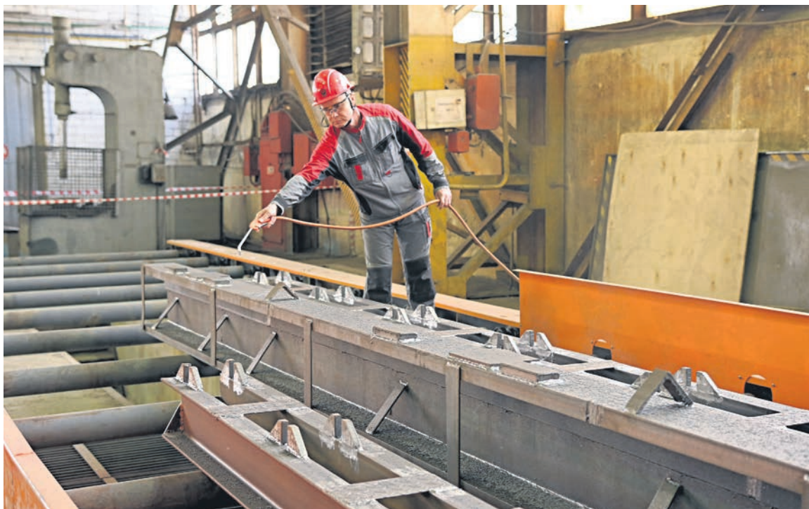
▲ Дробемётная установка не предусматривает потерь стальной дробы, на выходе её сдувают в приёмный бункер и пускают в новый оборотный цикл
